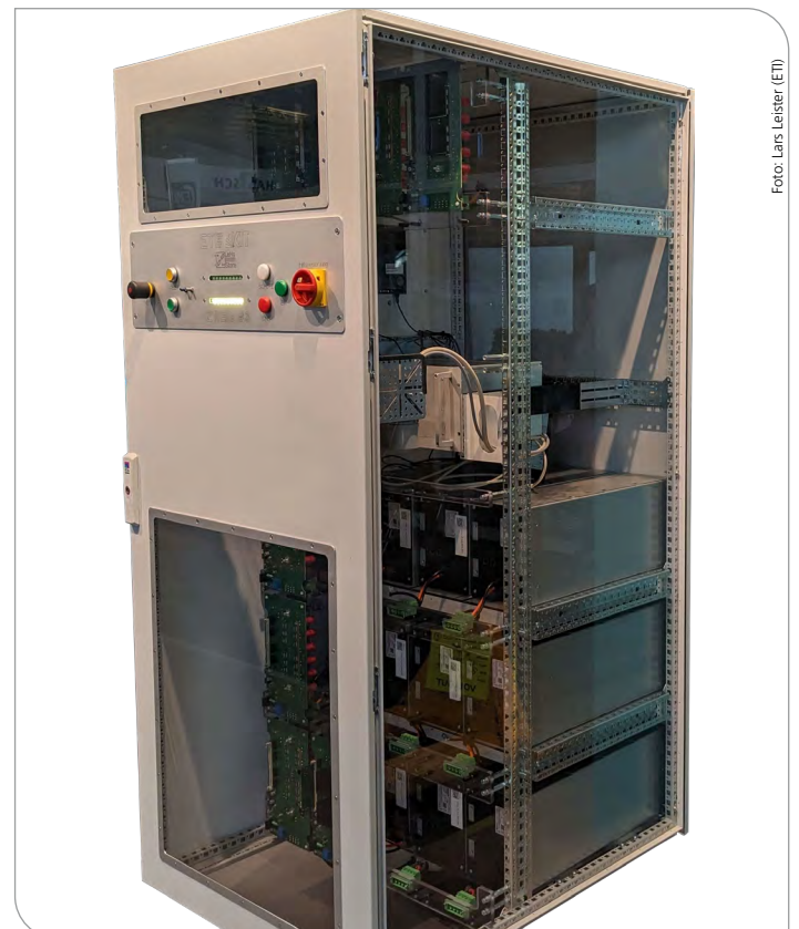
Ein Schaltschrank (Zweig) des insgesamt sechs Zweige umfassenden Gesamtsystems.
